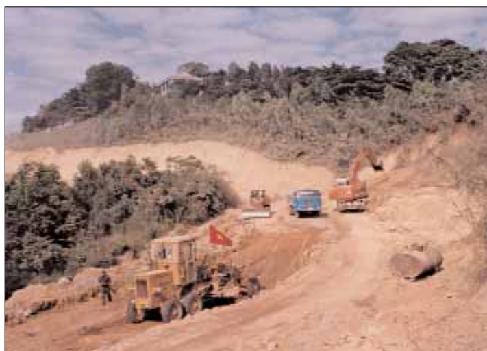
Đội hình thiết bị thi công trên công trình nâng cấp nghĩa trang liệt sỹ Trường Sơn của Đoàn 384 - Binh đoàn 12
